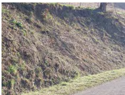
Figure 13 : Commune de Montagudet Lieu dit « Laval » Loupe de glissement dans le talus
